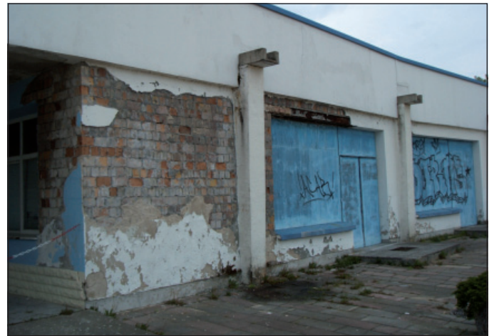
Witterungserfall des denkmalgeschützten Baukörpers.
